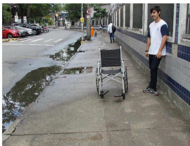
Figura 6. Inclinação da calçada da rua General Canabarro próxima a entrada do CEFET. Fonte: arquivo pessoal do autor 2019.
